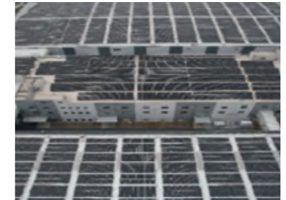
▪ 派能科技安徽合肥工厂屋顶光伏分布式发电项目
