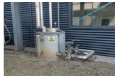
蒸汽冷凝水回收系统
