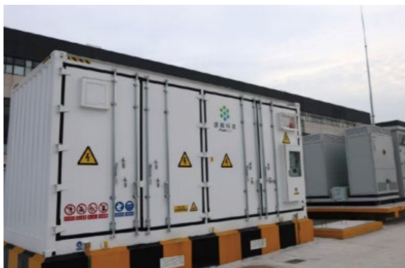
▪ 派能科技江苏扬州工厂光伏配储项目
