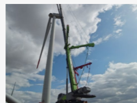
风电机组叶片梯次换长提质增效应用郭家店项目
