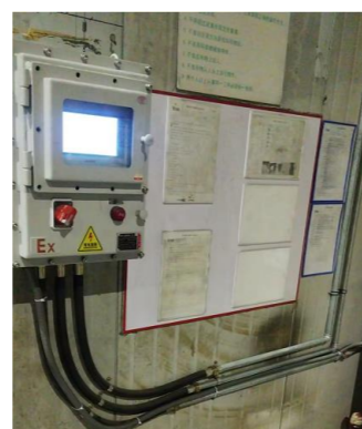
▲ 图为喷涂车间抛丸机粉尘浓度报警连锁装置
