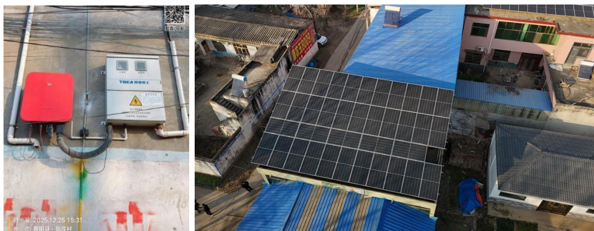
图 2 逆变器及光伏电站资产
