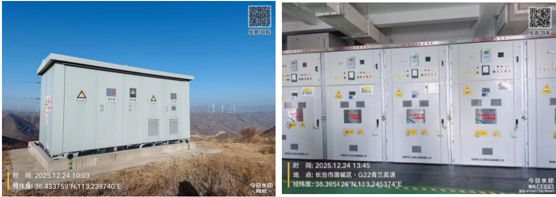
图 5 升压站及箱变资产
