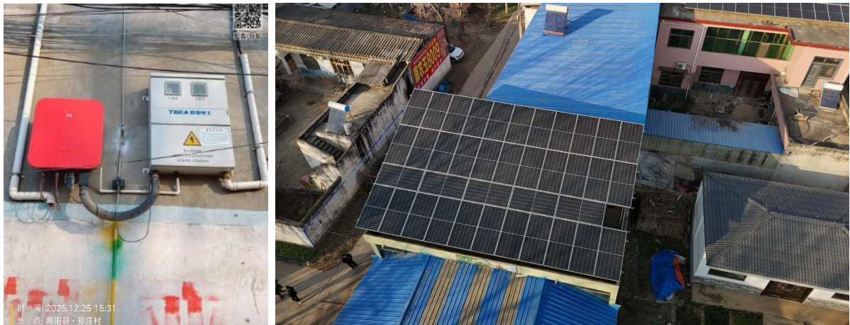
图 2 逆变器及光伏电站资产
