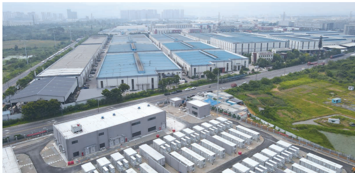
2025年7月14日，龙泉驿区电化学储能电站并网投运，11月27日转商
