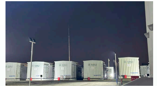
龙泉驿储能电站
