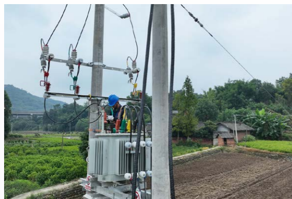
农村电网建设
