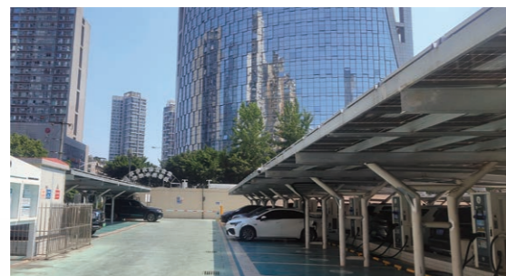
停车棚光伏发电项目
