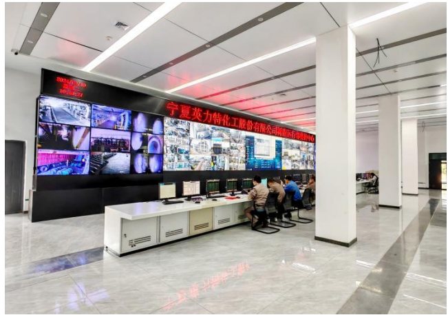
树脂运行部集控室内部
