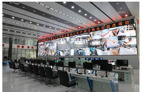
电石技改项目集控室
