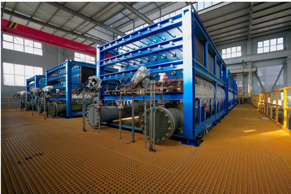
氯碱运行部电解槽 48/137
