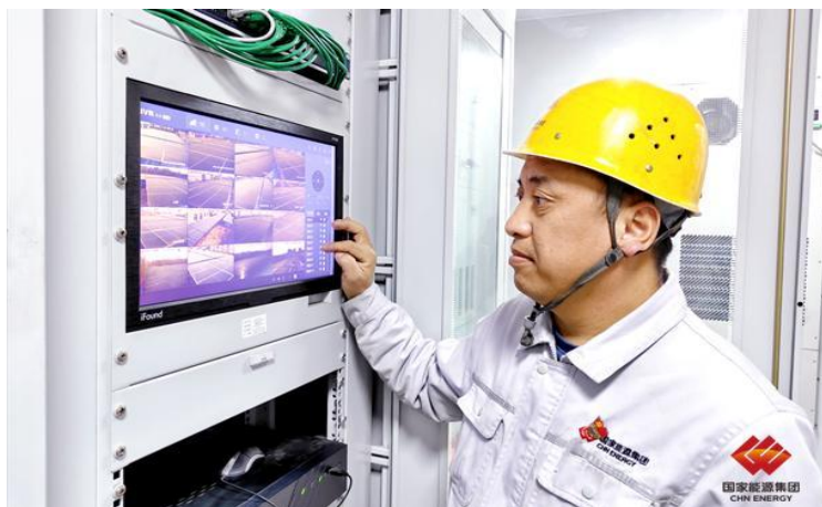
技术人员检查光伏系统运行参数
