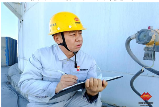
技术人员开展可燃和有毒气体报警系统隐患排查
