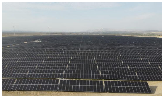
“风电+光伏”项目
