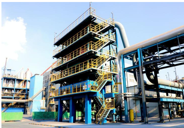
电石技改项目炉前净化装置
