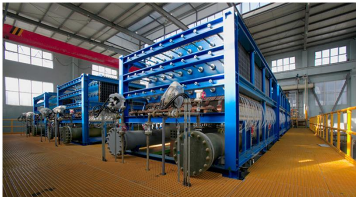
氯碱运行部电解槽
