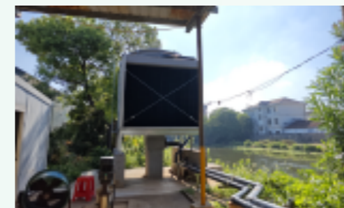
冷却系统节能技改项目
