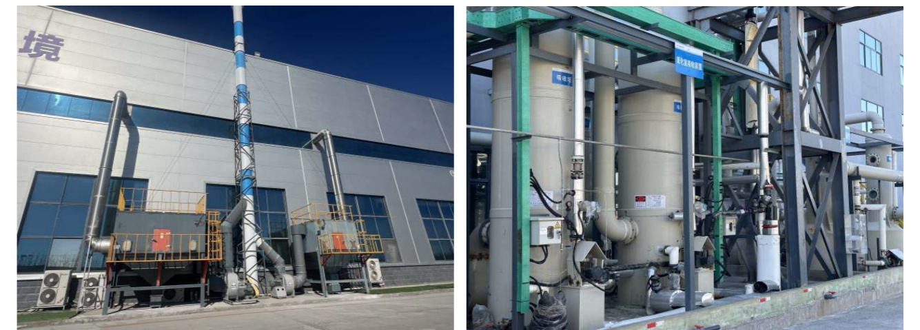
▶ 废气处理设施
