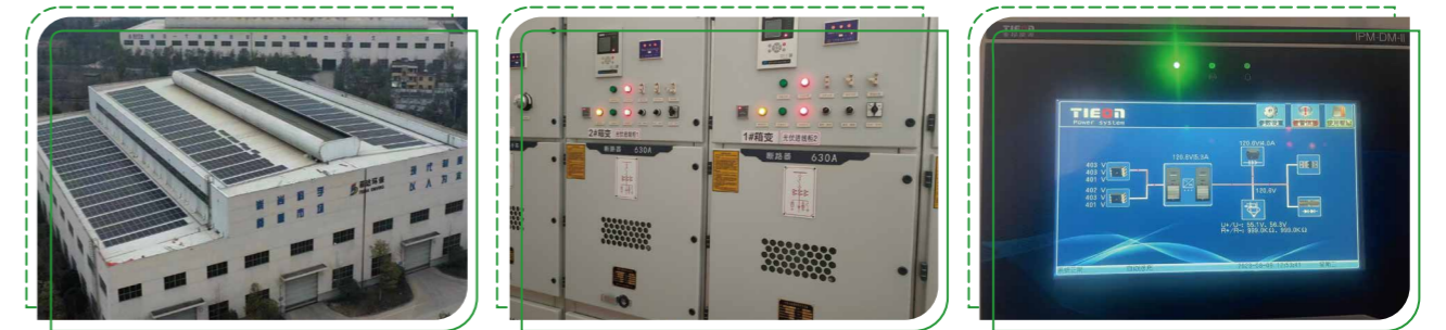
公司车间顶部布设太阳能光伏板/光伏发电控制室/光伏发电控制系统
