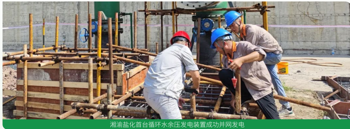
湘渝盐化首台循环水余压发电装置成功并网发电
