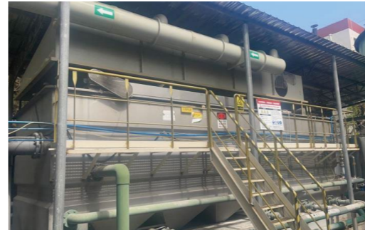
废水处理设施
