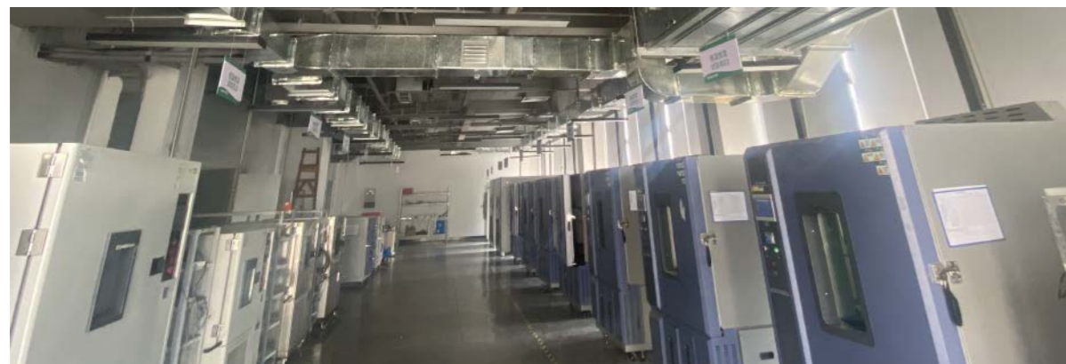
产业园实验室新风交换系统
