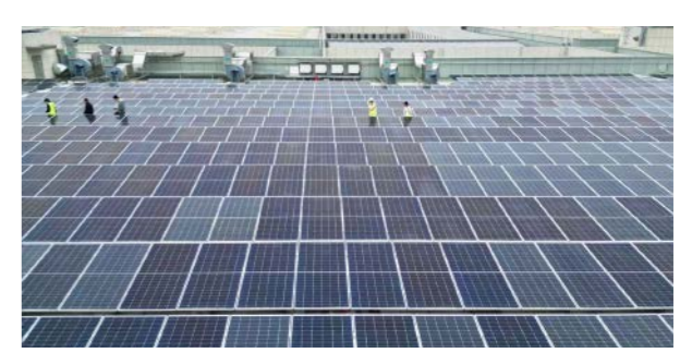
产业园屋顶光伏
