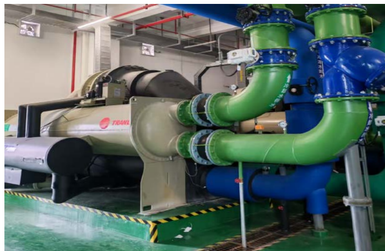
产业园循环水冷空调
