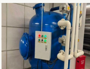
二次供水水箱设备
