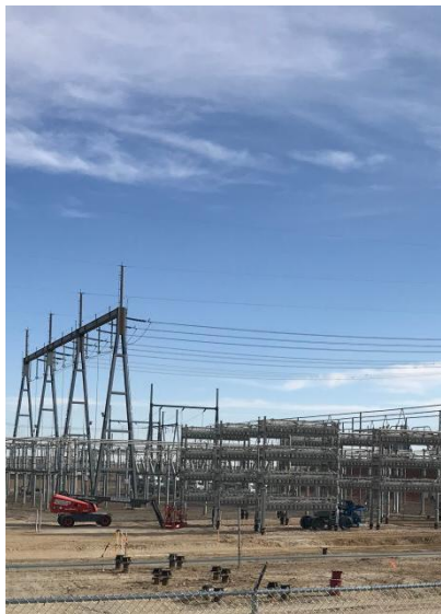
美国 AAJB 变电构支架
