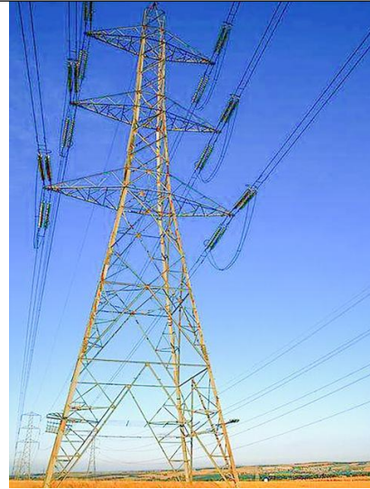
晋东南—南阳—荆门 1000 千伏特高压交流试验示范工程
