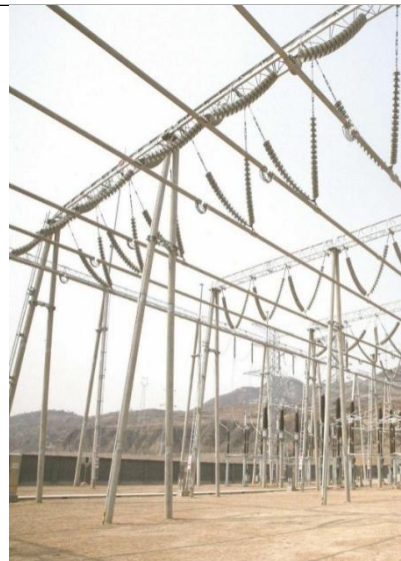
500 千伏淮宿变电站
