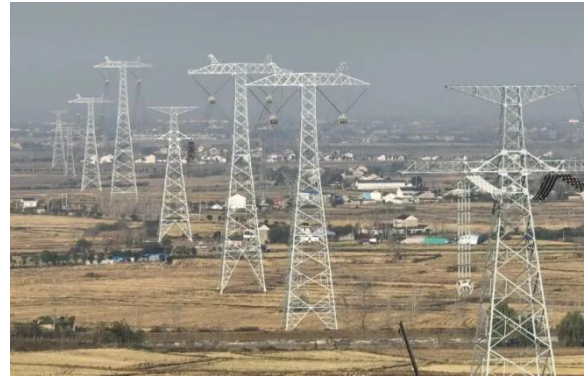
陕北—安徽±800 千伏特高压直流输电工程
