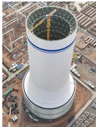
国际先进：钢结构间接空冷塔 （冷却塔）
