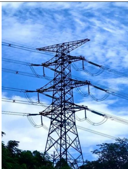
金上一湖北特高压工程
